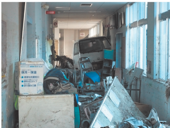
写真3-1 車やがれきで埋まる学校の廊下
